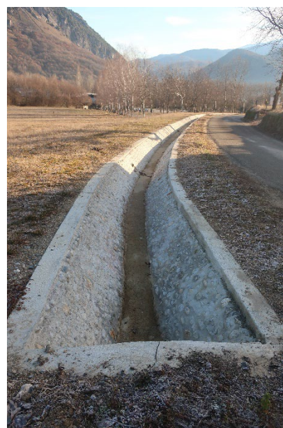
Photo Mme le CE 2023 état du fossé remanié le long de la RD 23
